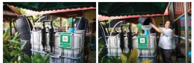
รูปที่ 1 สถานีติดตั้งระบบถังสุดดีที่ 11 ของจังหวัดน่าน
